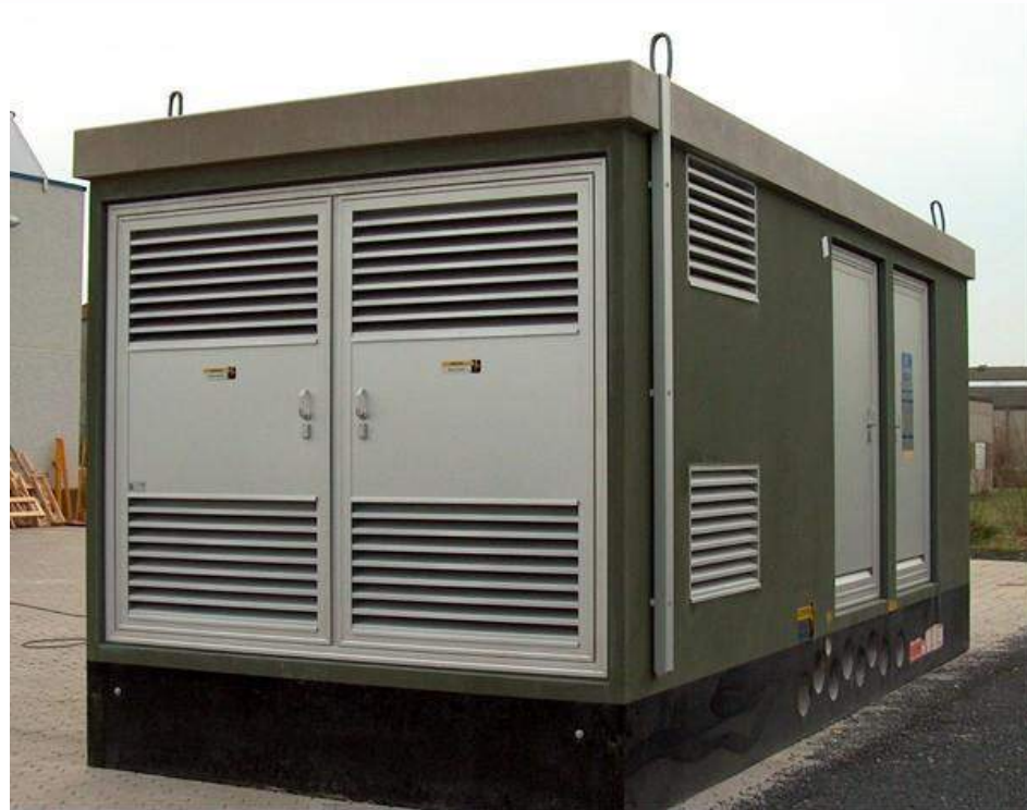
Photographie 7 Poste de livraison
